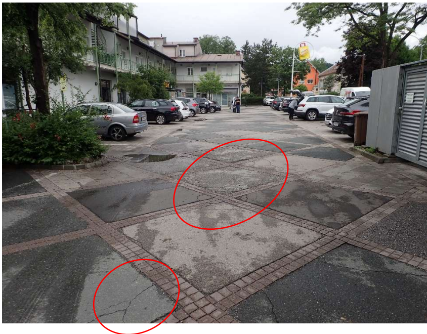
Außenanlage Nord (rissige Asphaltflächen, Müllraum)
