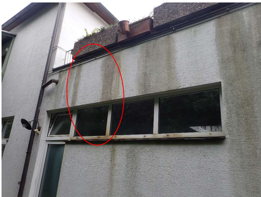
Südfassade Gebäudeteil 13 (Verwitterung Fassade, Durchgang Stiegenhaus 13)
