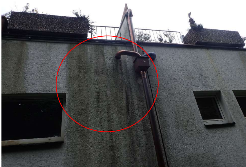
Südfassade Gebäudeteil 13 (Verwitterung Fassade)
