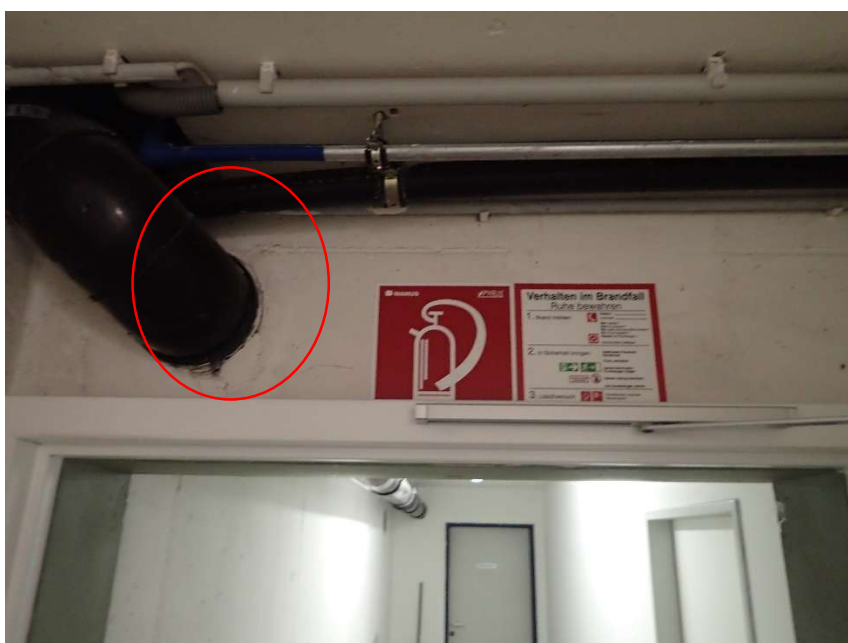
Gebäudeteil 11, Kellergeschoss (Leitungsdurchführung ober Brandschutztür ohne Abschottung)
