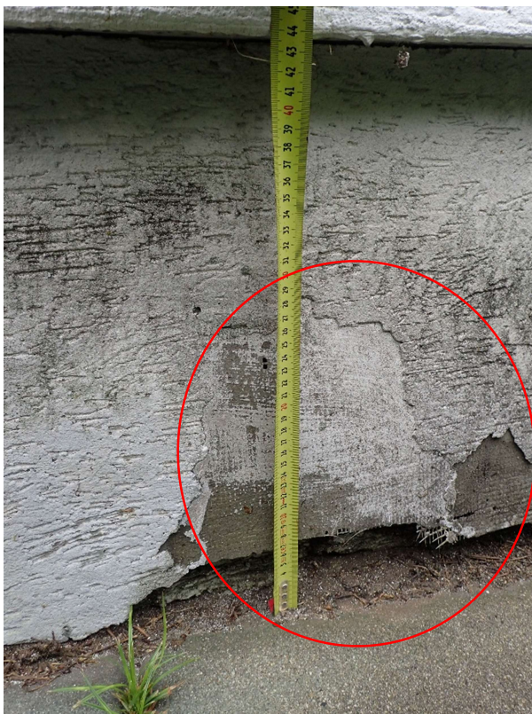
Südfassade Gebäudeteil 11 (Verwitterung/Abplatzung Sockelbereich)
