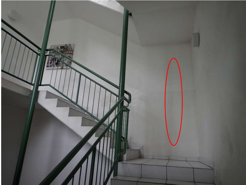
Stiegenhaus 11a/13, Obergeschoss 1 (Wandriss Podest)
