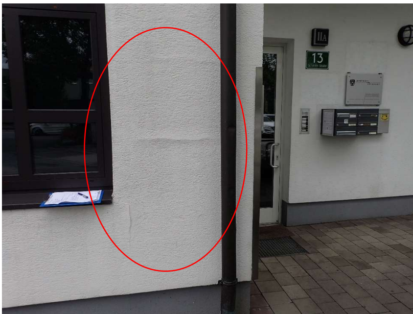
Gebäudeteil 13, Nordfassade (Aufwölbung Außenputz vor Zugang Stiegenhaus 11a/13)
