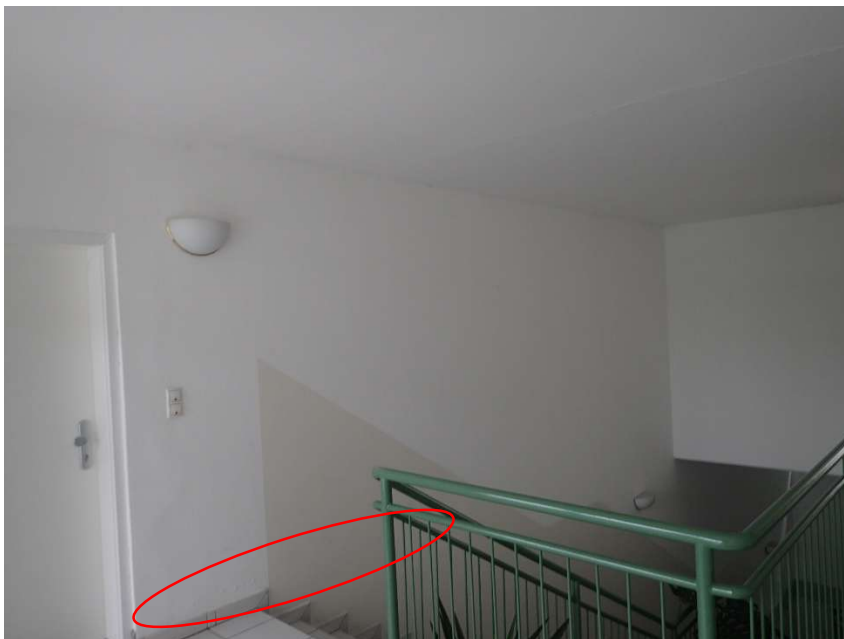
Stiegenhaus 13, Obergeschoss 1 (Rissbildung Sockel neben Top 12)
