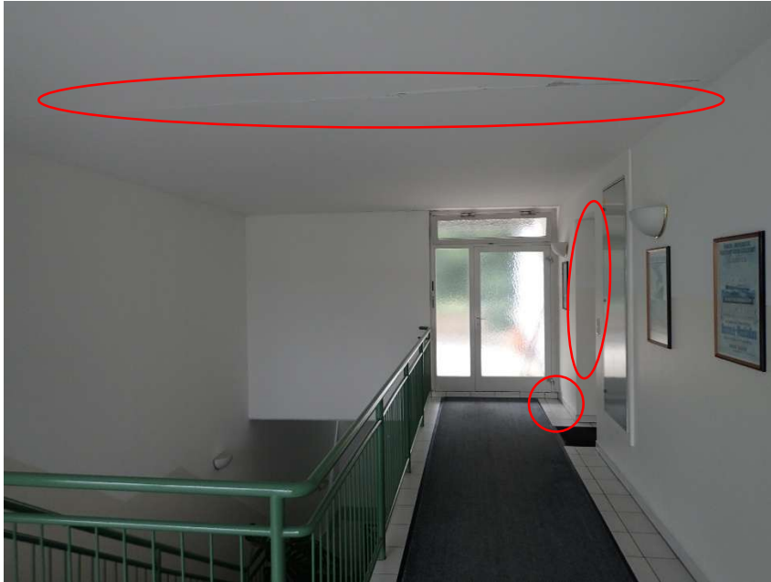
Stiegenhaus 13, Obergeschoss 1 (Riss Deckenuntersicht, Riss Leibung Top 11, abgehobene Randleiste)
