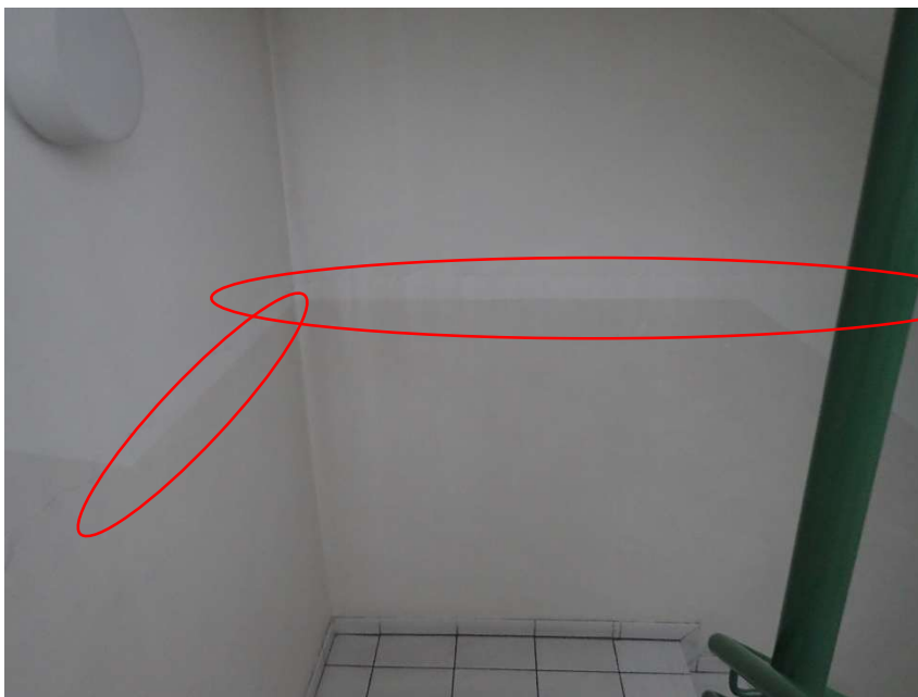
Stiegenhaus 11a/13, Kellergeschoss (Wandrisse Zwischenpodest)
