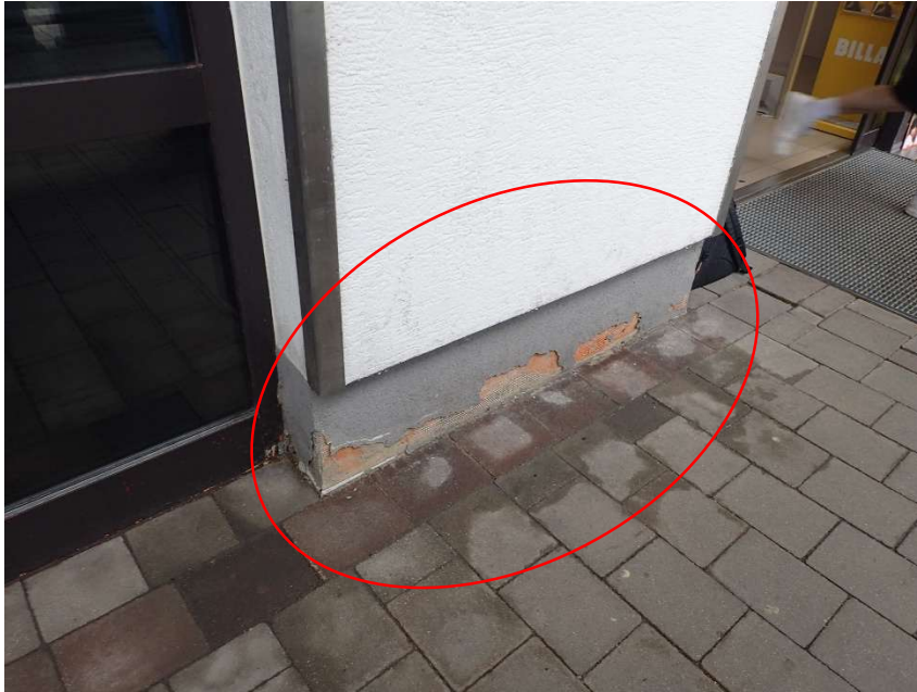
Gebäudeteil 13, Nordfassade (abgegangener Sockelputz neben Eingang Supermarkt)
