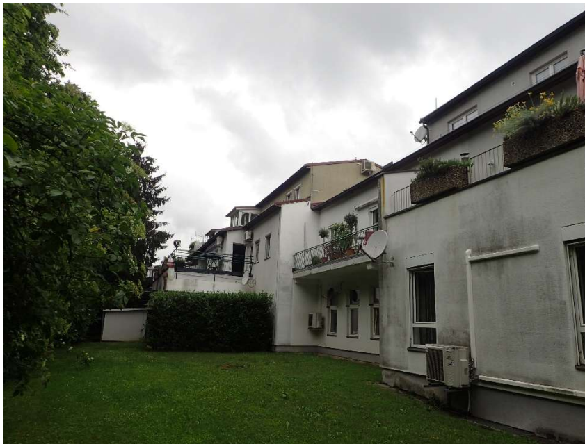
Südfassade Gebäudeteile 13+11 (Verwitterung Putzfassade, Gartenhütte)
