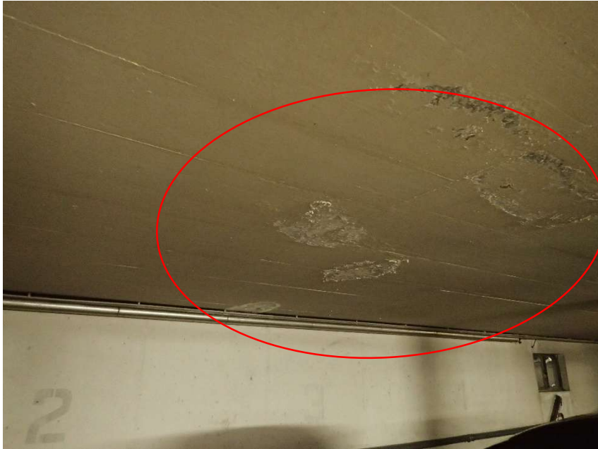
Tiefgarage (Feuchtigkeitsausblühungen Deckenuntersicht Stellplatz 02)
