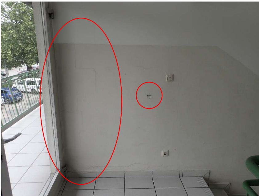
Stiegenhaus 11, Obergeschoss 1 (Wandrisse, Putzabschlag)
