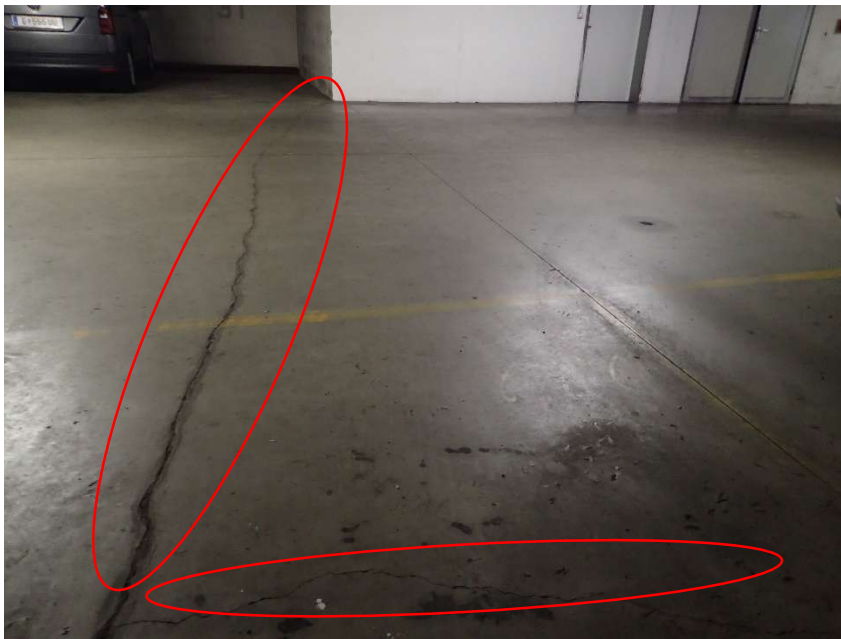
Tiefgarage (Rissbildung Bodenplatte zwischen Stellplätzen 01, 02 - 31)
