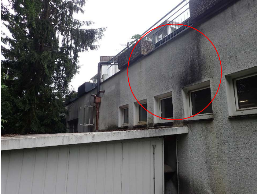
Südfassade Gebäudeteil 11 (Verwitterung Putzfassade, Gartenhütte)
