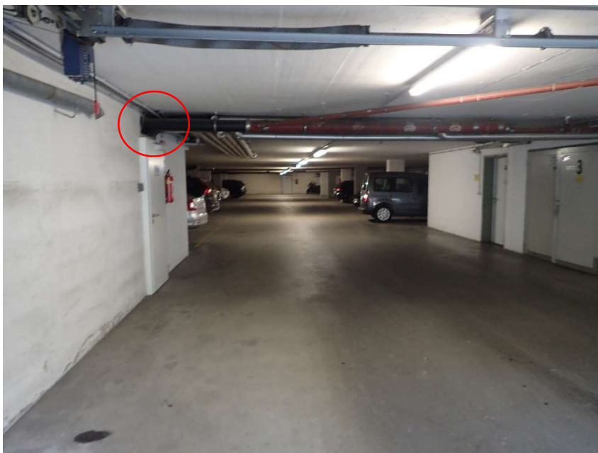
Gebäudeteil 13 (Einfahrt Tiefgarage, WDB ober Brandschutztür ohne Schott)
