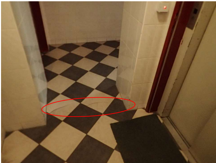
Kellergeschoss, Vorraum Aufzug (geborstene Fliesen)
