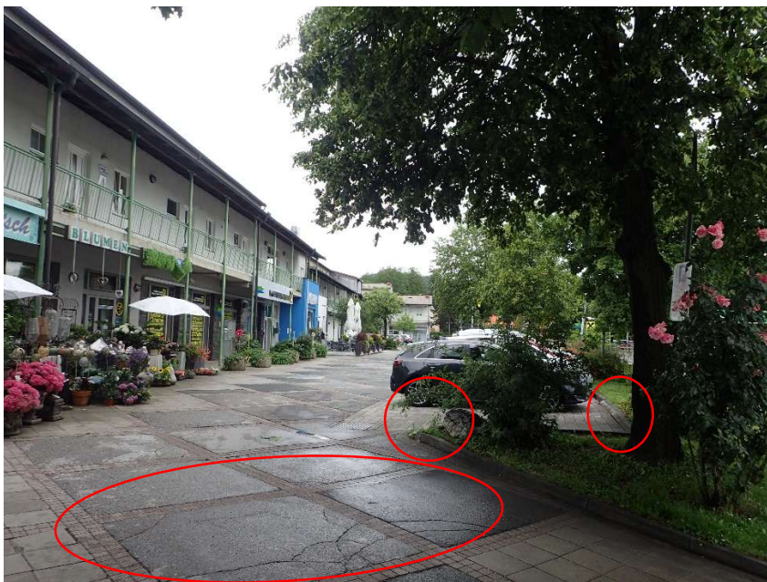
Nordfassade Gebäudeteile 11+ 13 (Außenanlage mit rissigen Asfaltflächen und Randsteinen)
