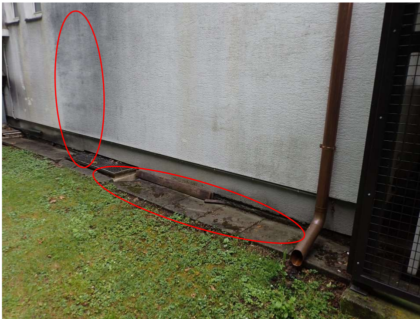
Südfassade Gebäudeteil 11 (Verwitterung Putzfassade, Absenkung Traufenstreifen)
