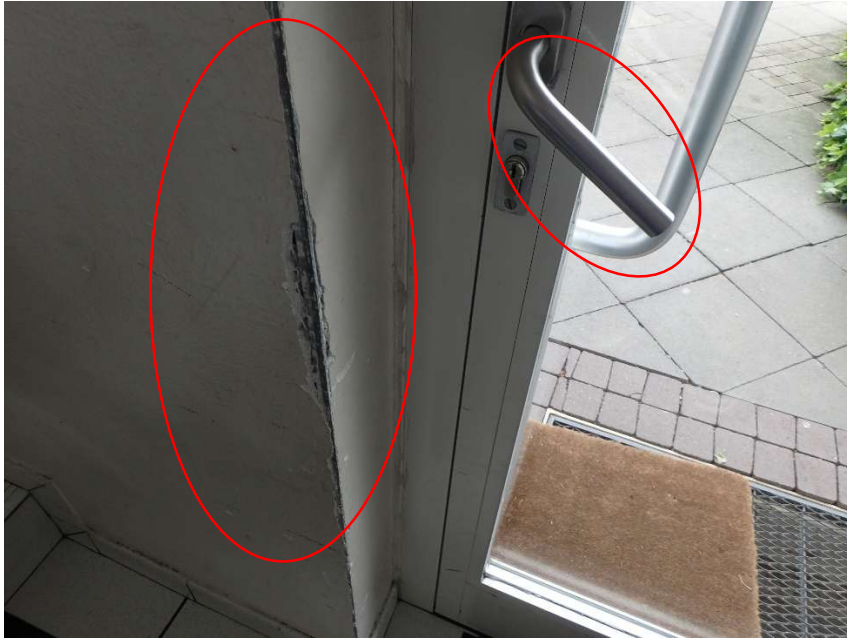
Stiegenhaus 11, Erdgeschoss (beschädigte Putzkante Eingangstür)
