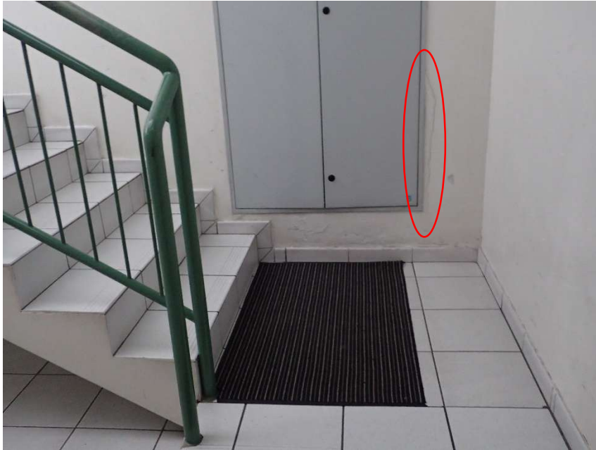
Stiegenhaus 11, Kellergeschoss (Rissbildung neben E-Schrank Podest)
