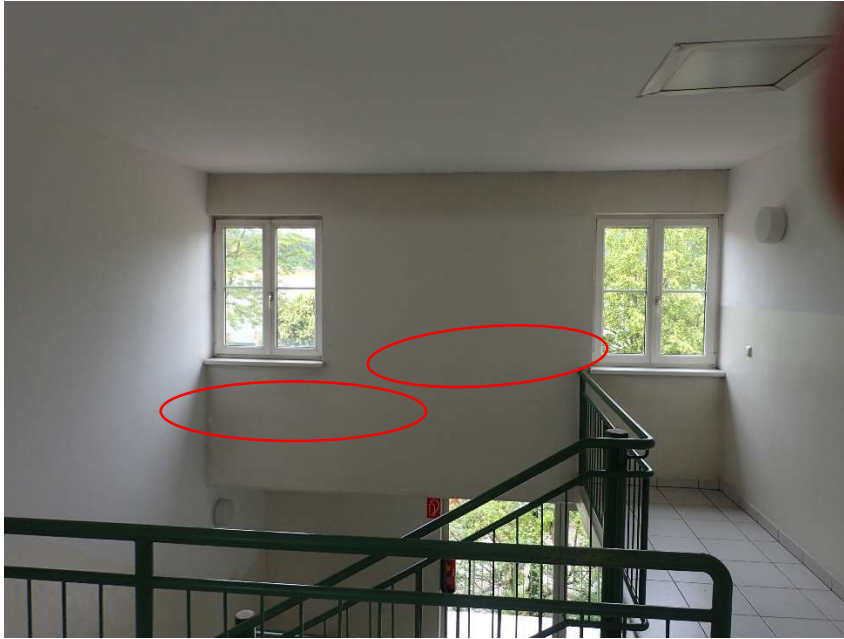
Stiegenhaus 11a/13, Obergeschoss 2 (Rissbildungen Wand Nord)
