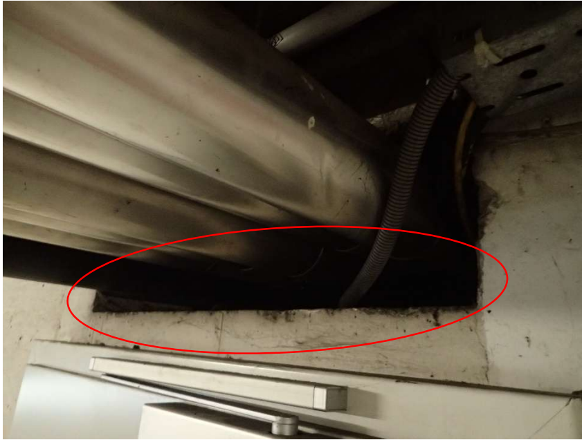
Tiefgarage (Brandschutztür ohne Schott)
