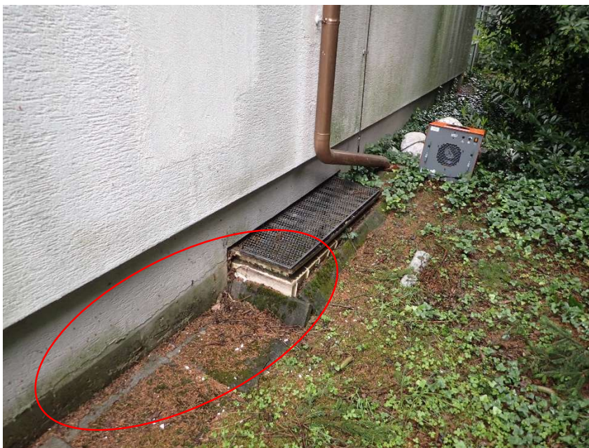
Südfassade Gebäudeteil 13 (abgesunkener Traufenstreifen, offenliegende Sockeldämmung)
