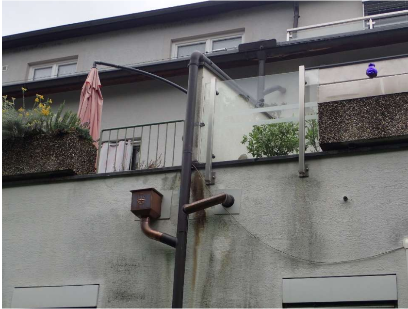
Südfassade Gebäudeteil 11 (Verwitterung Putzfassade)
