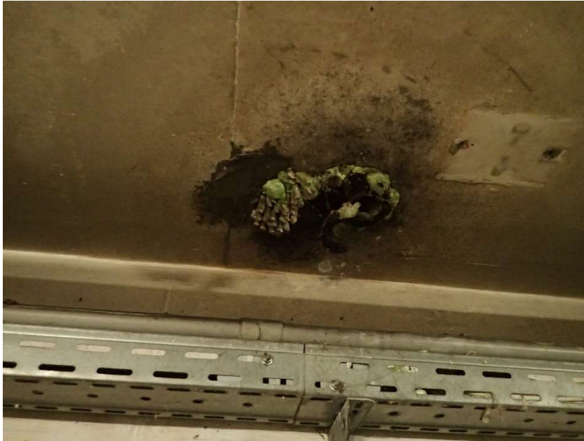
Tiefgarage (Kabelstrang DDB Deckenuntersicht Stellplatz 27)
