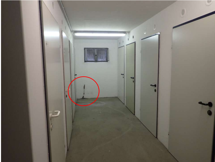
Gebäudeteil 11, Kellergeschoss (Seitengang Lager, Feuchtigkeitsausblühung Außenwand Süd)
