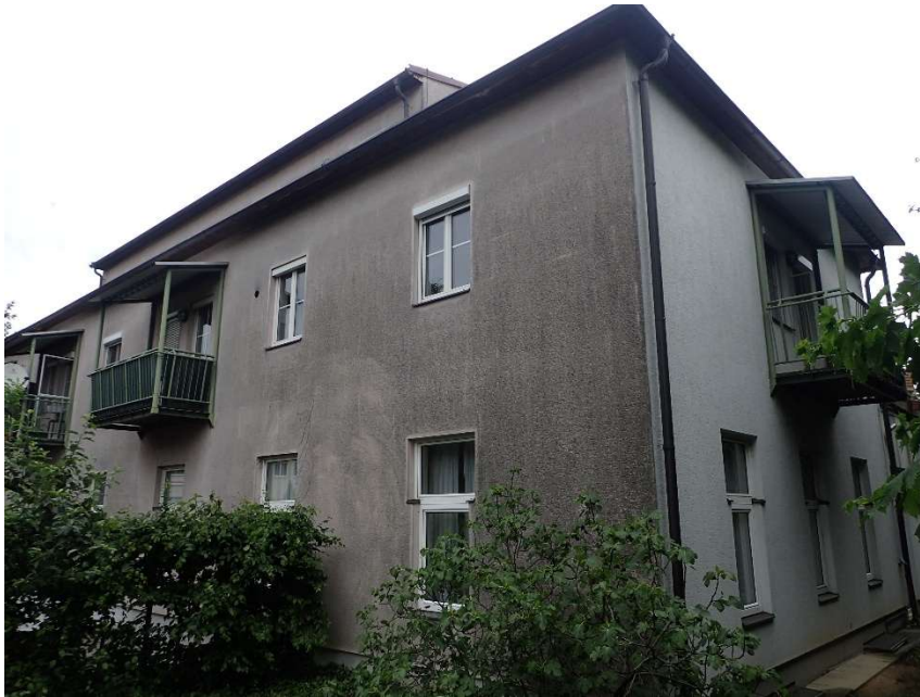
Westfassade Gebäudeteil 13 (Verwitterung Fassade, Balkonausbildungen OG1)
