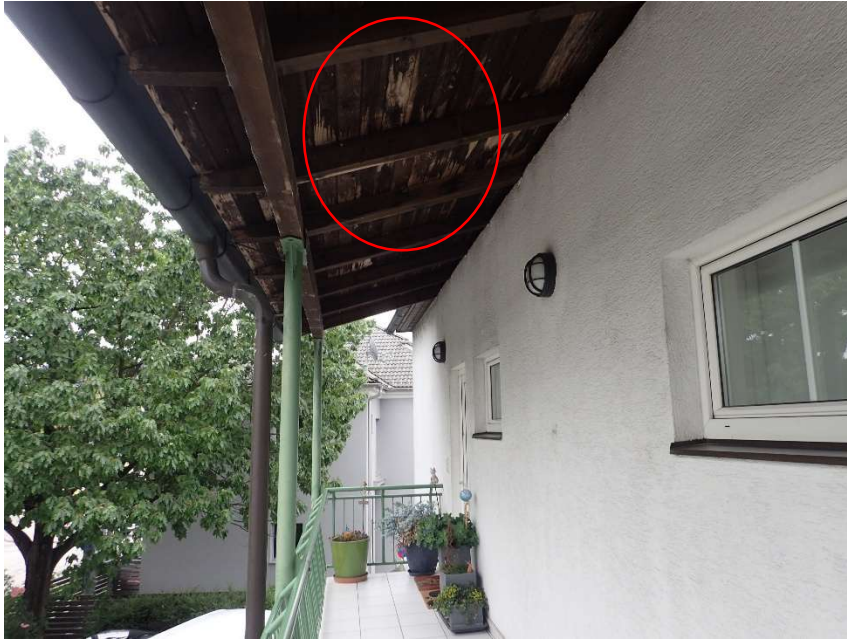
Gebäudeteil 11, Laubengang Obergeschoß 1 (Beschichtung Bretterschalung Dachuntersicht)
