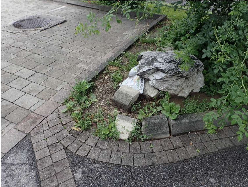
Außenanlage Nord, Gebäudeteil 11 (geborstene Randsteine)
