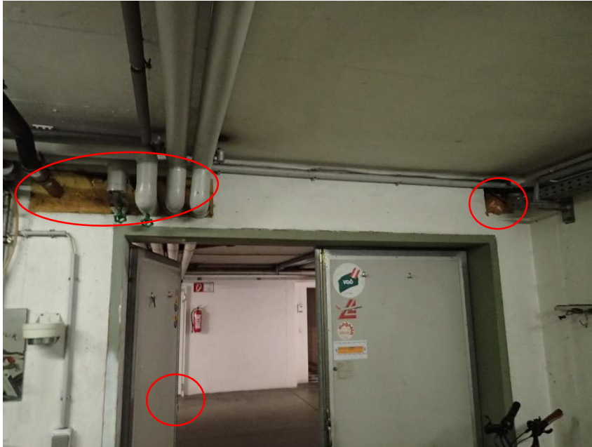
Tiefgarage Fahrradraum (Abschottungen WDB, fehlende Türschnalle)
