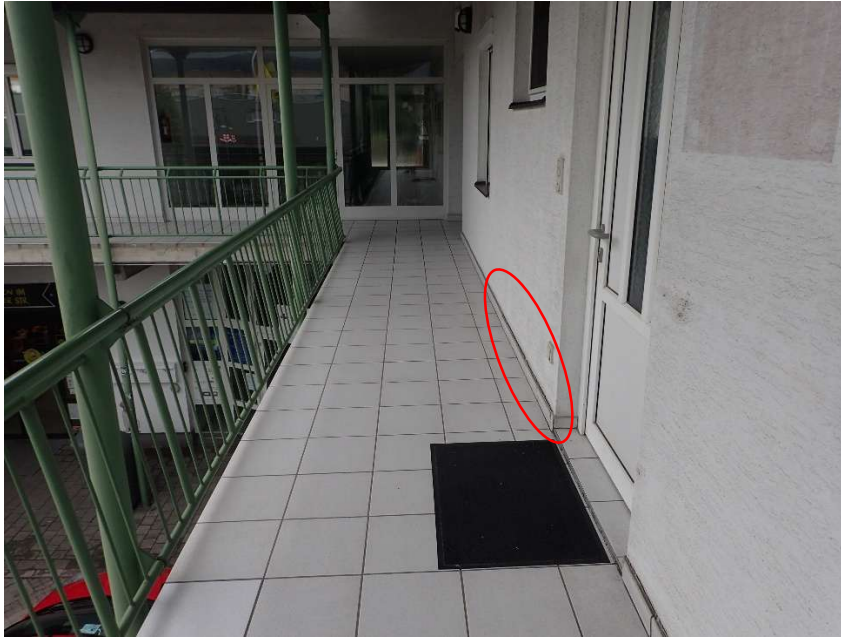
Gebäudeteil 13, Laubengang Obergeschoss 1 (abgehobene Randleisten zwischen Top 09 und 10)
