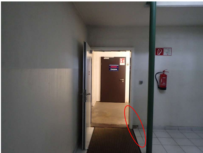
Stiegenhaus 11a/13, Kellergeschoss (abgegangene Randleiste)
