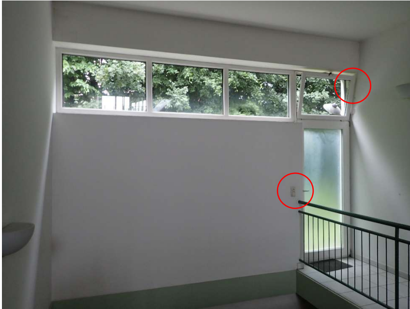
Erdgeschoss, Stiegenhaus 13 (Feuchtigkeitsausblühung Wand, fehlende Türklinke außen)
