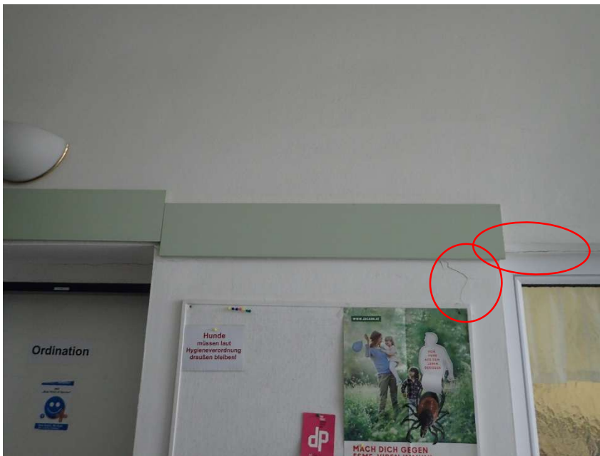
Erdgeschoss Stiegenhaus 13 (Rissbildungen Wand Arztpraxis)
