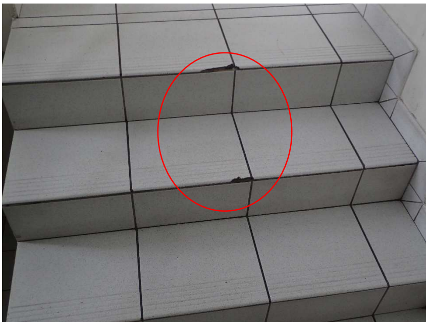
Stiegenhaus 11, Erdgeschoss (beschädigte Fliesen)
