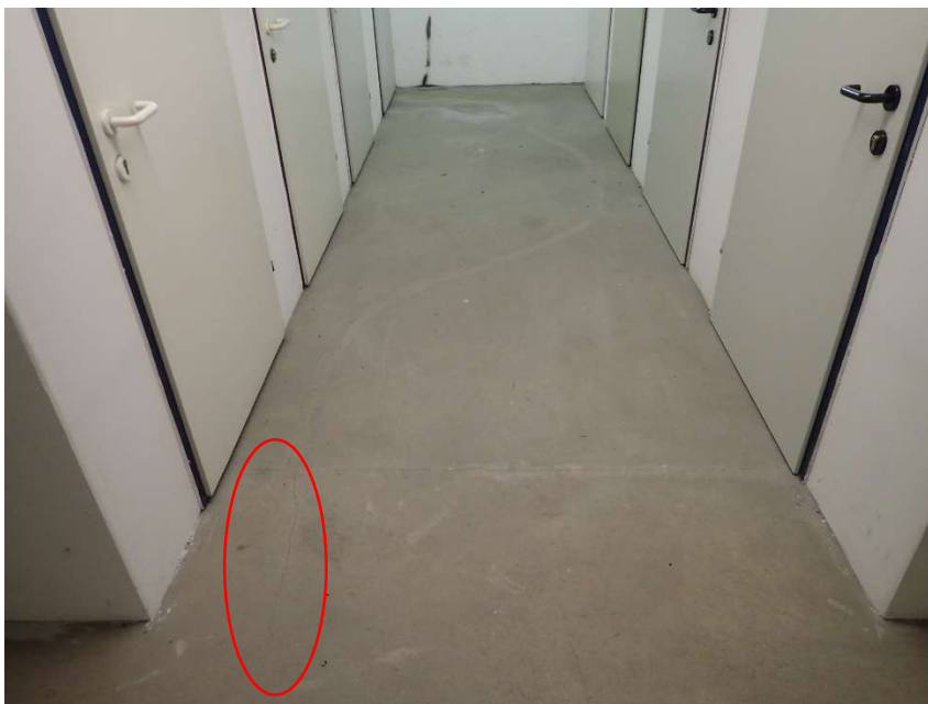
Gebäudeteil 11, Kellergeschoss (Seitengang Lager, Riss Estrich)
