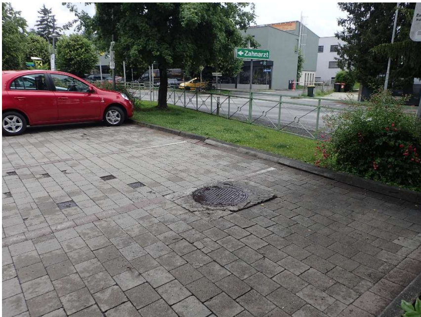
Außenanlage Nord, Gebäudeteil 11 (geborstene Betonsteinpflasterungen, Randsteine)
