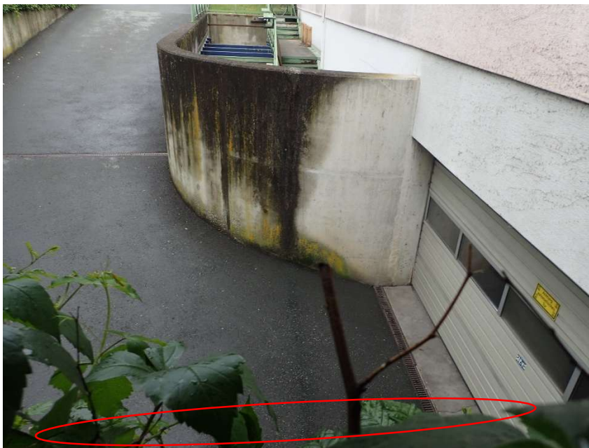
Westfassade Gebäudeteil 13 (Abfahrt Tiefgarage, fehlende Abgrenzung)
