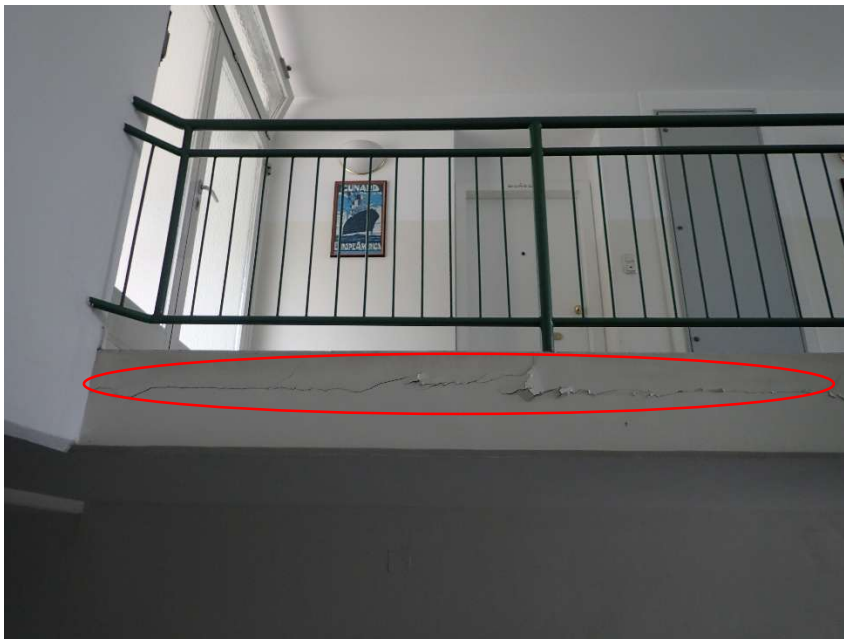
Stiegenhaus 13, Erdgeschoss-Obergeschoss 1 (Riss Wange Podest)
