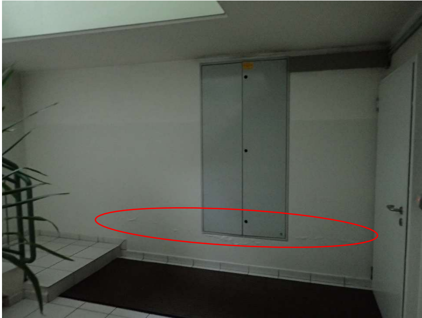
Kellergeschoss, Stiegenhaus 13 (Ausblühungen und Riss Wand)
