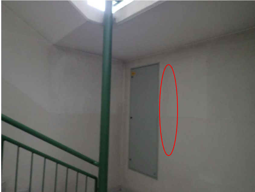
Stiegenhaus 11a/13, Kellergeschoss (Wandriß neben E-Schrank)
