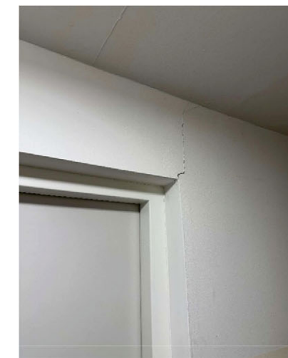
Bild 3: Risse Tür 2. OG
