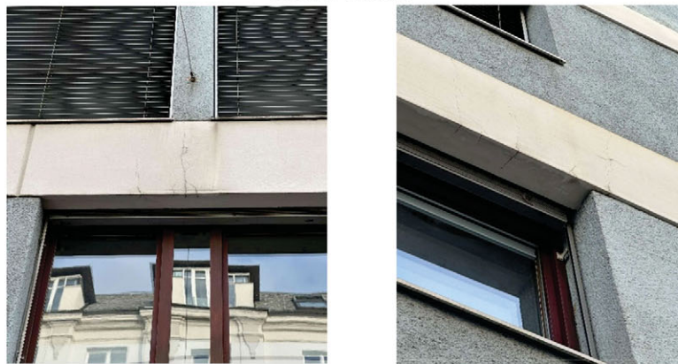
Bild 2+3: Risse in der Fassade
